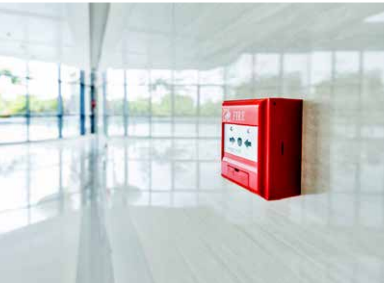
Feuermelder sind wesentliche Bestandteile einer Brandschutzanlage
