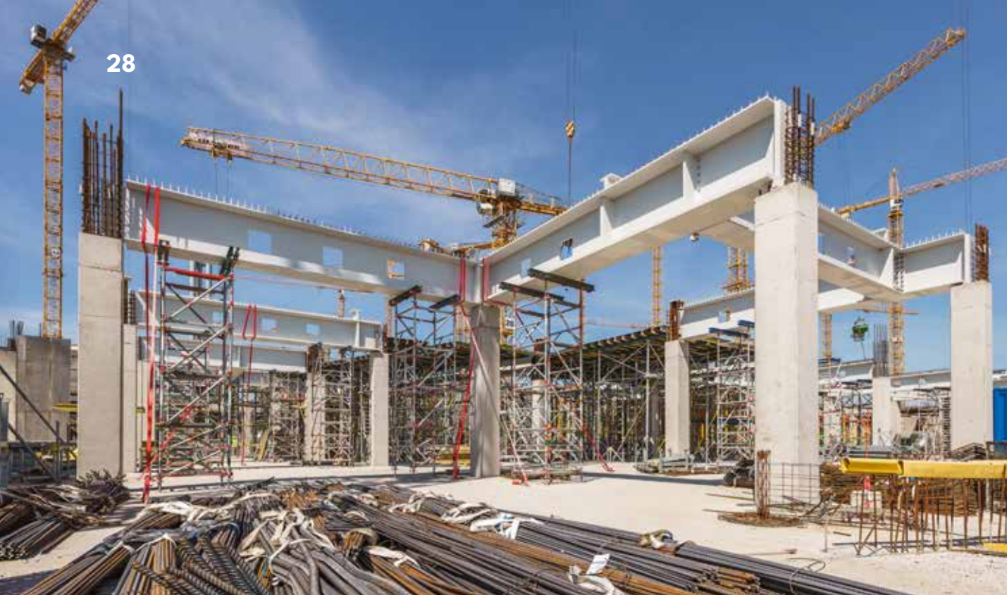
Weitgespannte Träger über dem Mall-Bereich sowie komplexe, sehr hoch belastete Trägerroste im Bereich des Kreuzfahrtterminals
