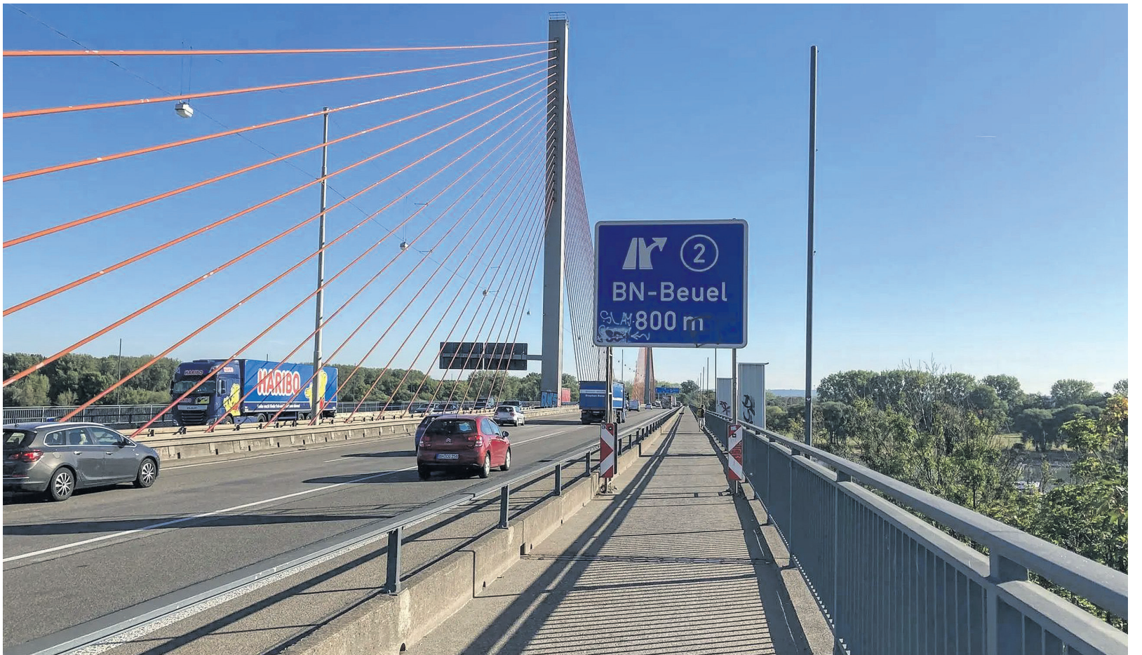
Marode Infrastruktur bremst die Mobilität in Deutschland zunehmend aus. So zum Beispiel im Großraum Bonn. Die Nordbrücke über den Rhein (A 565) musste dort im Juni wegen Einsturzgefahr komplett gesperrt werden. Sie wird nun abgerissen und neu gebaut. Das Vergabebeschleunigungsgesetz soll solche dringenden Bauprojekte künftig vereinfachen.
